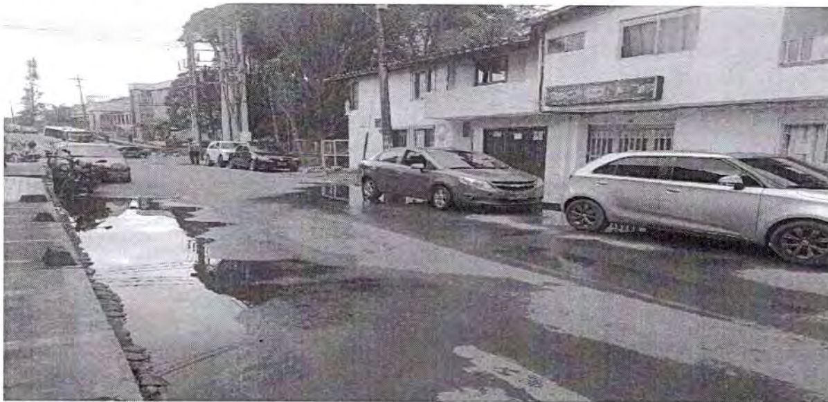
Fotografía: empozamiento sector los lagos Fuente: Equipo Auditor
