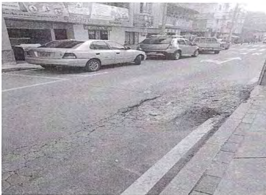
Fotografía: Afectación en reparcheo, calle 54 entre la carrera 50 y 51 Fuente: Equipo Auditor
