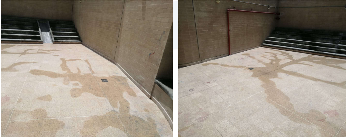
Humedades en losa expuesta a la intemperie. Evidencias equipo auditor.
