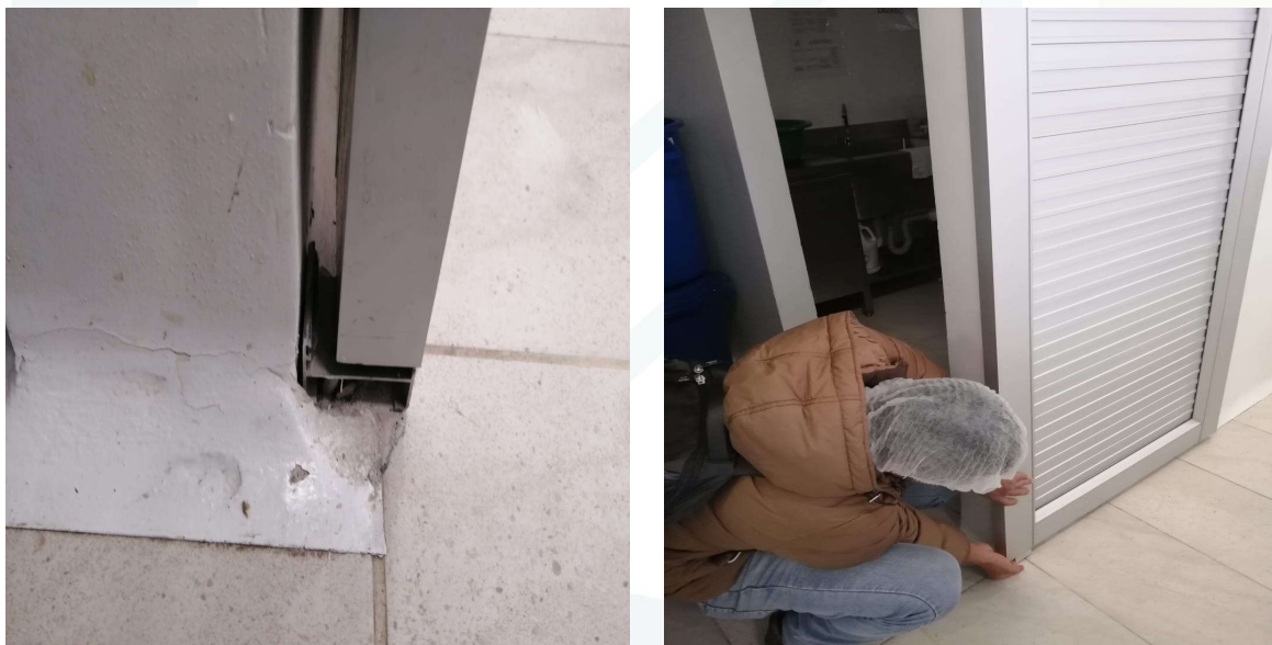
Desprendimiento de soporte guía inferior de la puerta corrediza en cocina Evidencias equipo auditor
