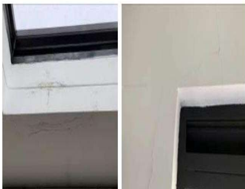
Detalle filtración humedad claraboyas y fisuramiento de muros Fuente: Registro Fotográfico Auditoría (02/06/2020) Elaboró: Juan Camilo Gómez Berrío, CA
